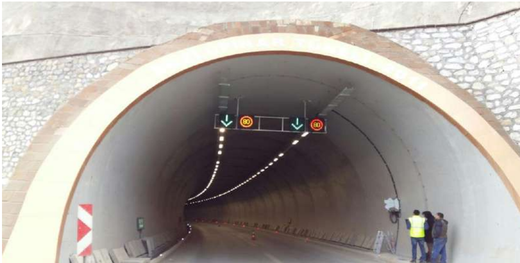
Şekil 3. T4 ( Buzlu Pınar Tüneli) LED Armatür İle Aydınlatılması [2]
