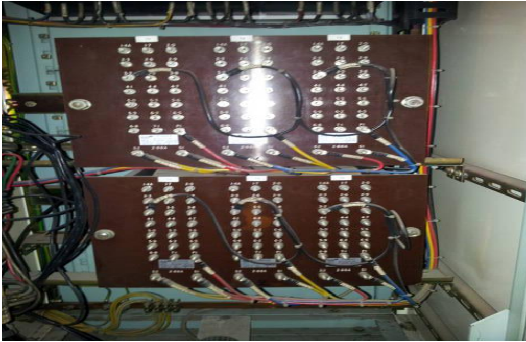
Şekil 5. Diferansiyel koruma rölesine ait adaptör akım transformatörü bağlantı yapısı
