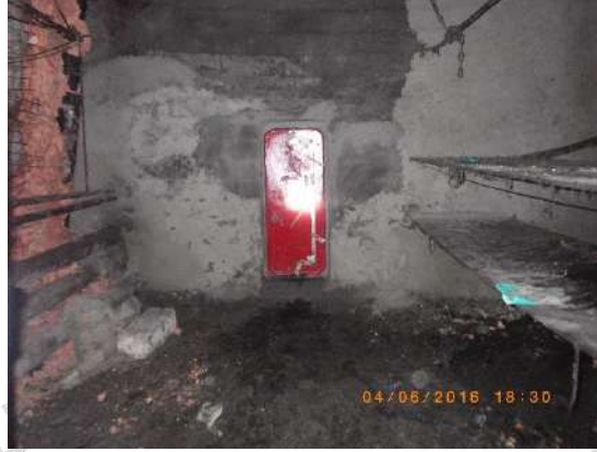
Şekil.3 Kapalı Yangın barajı
