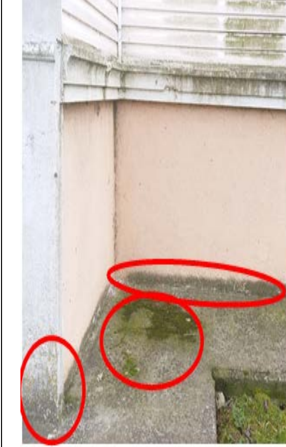
Şekil 5. Tretuvarda yosunlanma ve binada çiçeklenme
