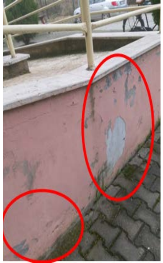
Şekil 10. Boya dökülmesi ve aşınmalar
