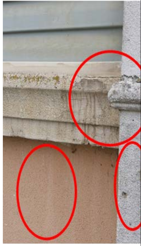
Şekil 12. Çatlak, Çiçeklenme, parça kayıpları
