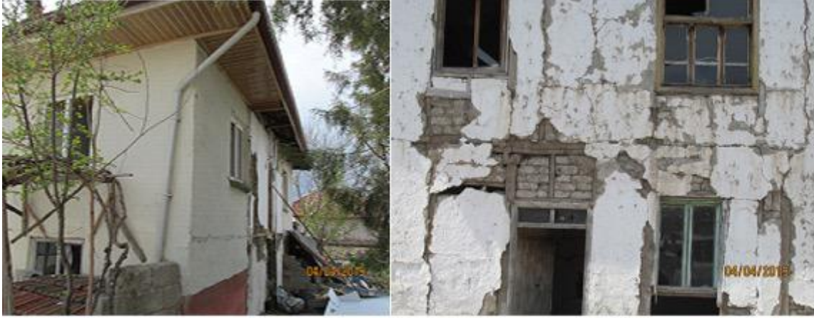
Şekil 5. Yapı Yakınında Bulunan Fosseptik Nedeniyle Oluşan Sıvılaşma Sonucu Binanın Hasarı ve Ahşap İskeletli Yapıda Duvar ve Sıva Çatlakları (Acıpayam Karahüyük).
