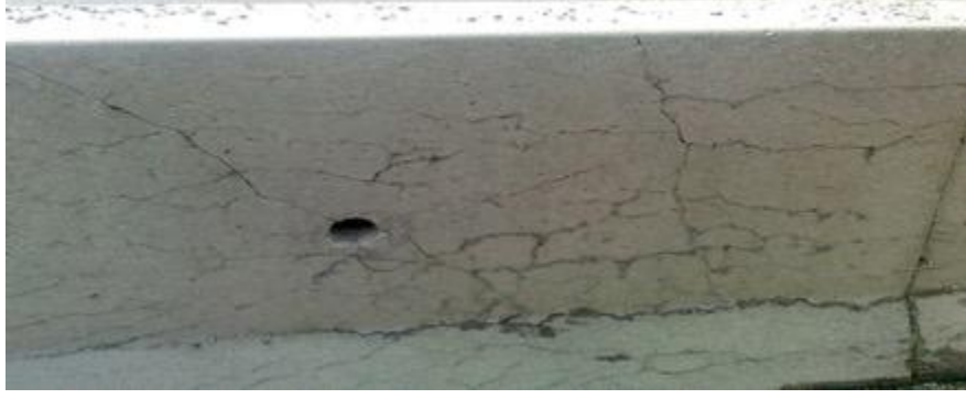
Şekil 1. Yol Bariyer Betonunda Gözlenen ASR Çatlakları.
