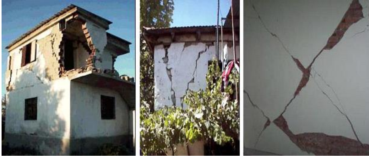
Şekil 2. Taşıyıcı Duvarlarda Görülen Deprem Hasarı Türleri [6].
