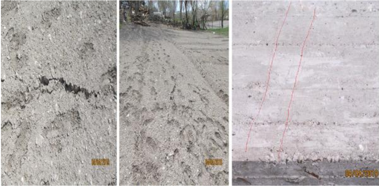
Şekil 6. Arazide Depremler Sonucu Oluşan Yer Kırık Hattı ve Beton Kiriş De Oluşan Kılcal Çatlak.
