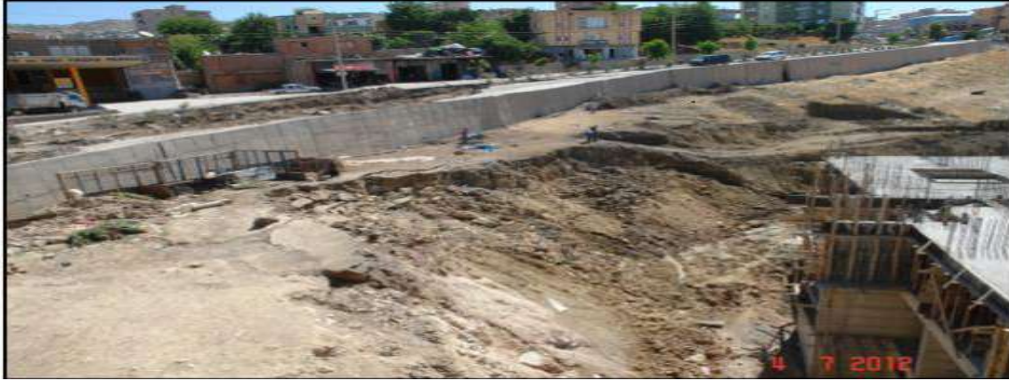
Şekil 1. Şırnak ili Tarım Lojman Binası Kazı sonrası Heyelan
